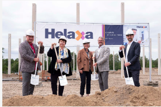
Symbolischer Spatenstich zum Baustart im Luckenwalder Biotechnologie Park. Bildrechte: Helaxa GmbH & Co. KG
